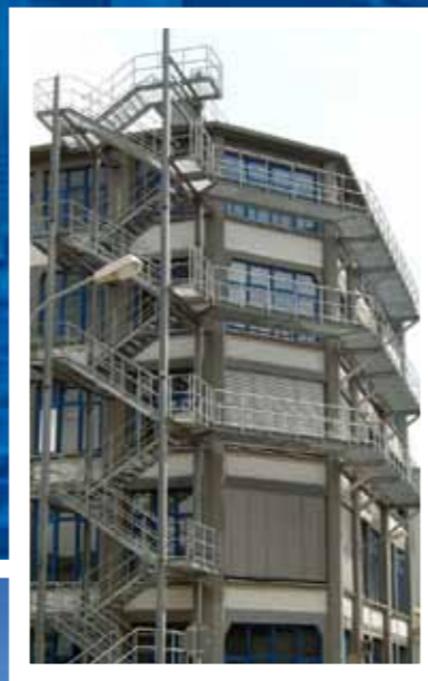
Fluchttreppe Schott Jenaer Glas GmbH
